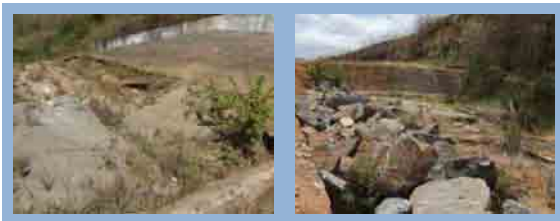
Figura 51 – Vertedouro antes da recuperação.
