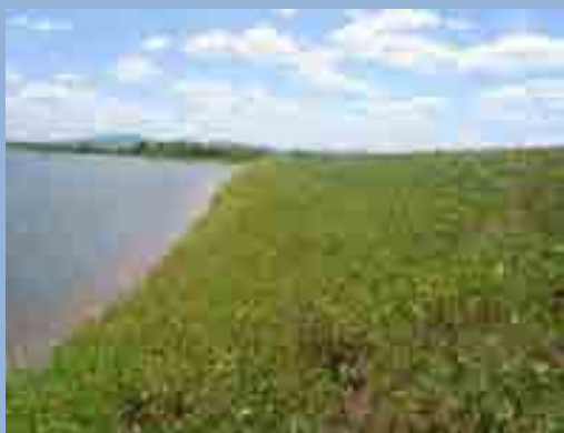
Figura 25 – Talude erodido e sem proteção.
