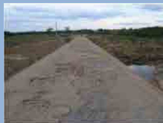
Figura 33 – Soleira antes da recuperação.
