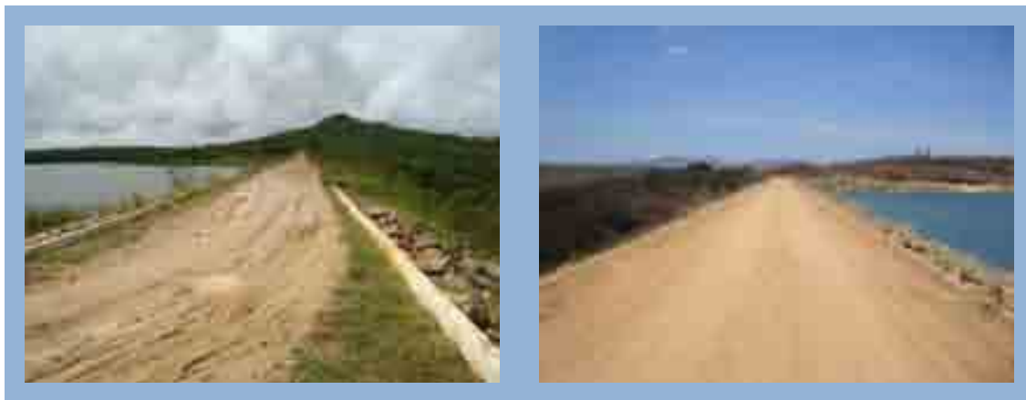
Figura 37 – Coroamento antes da recuperação.
