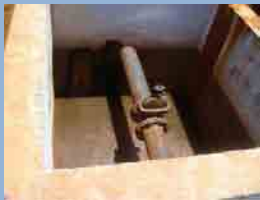
Figura 31 – Equipamento sem manutenção.
