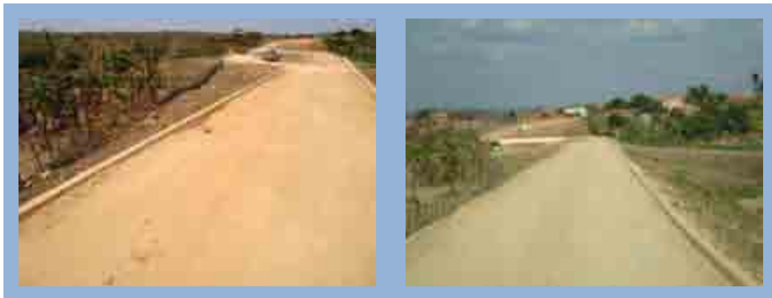
Figura 35 – Coroamento antes da recuperação.
