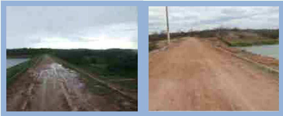
Figura 45 – Coroamento antes da recuperação.
