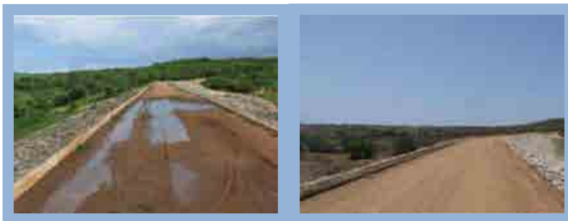
Figura 41 – Coroamento antes da recuperação.
