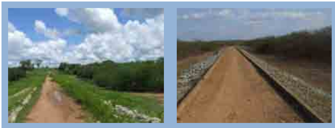
Figura 39 – Coroamento antes da recuperação.
