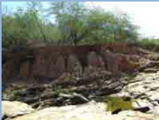
Figura 07 – Vista do talude erodido.
