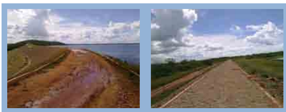
Figura 03 – Coroamento antes da recuperação.
