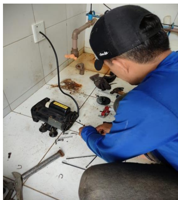
Comunidade Lagoa da Pedra – Ibaretama. Técnico durante a realização dos serviços de manutenção (Março 2022)
