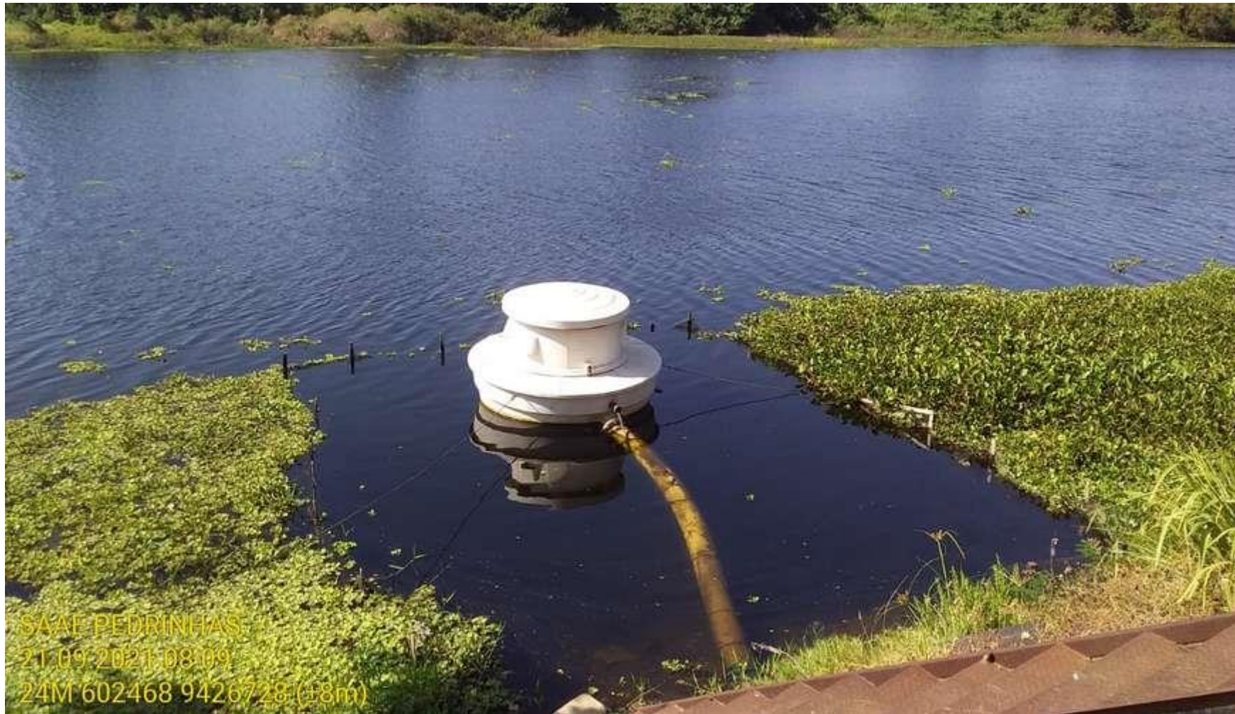
Captação no rio Jaguaribe, 21/09/2021
