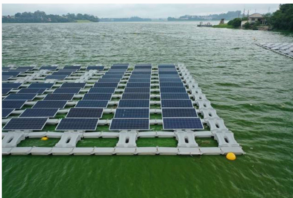
Figura 2 - Primeira etapa da usina solar fotovoltaica instalada pela Companhia Hidro Elétrica do São Francisco (Chesf) no reservatório da Usina Hidrelétrica de Sobradinho, na Bahia.
