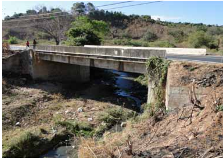
Figura 3 – Esgoto proveniente dos bairros Seminário e Batateira (UTM 9201491N / 455376E - 09.09.2010).
