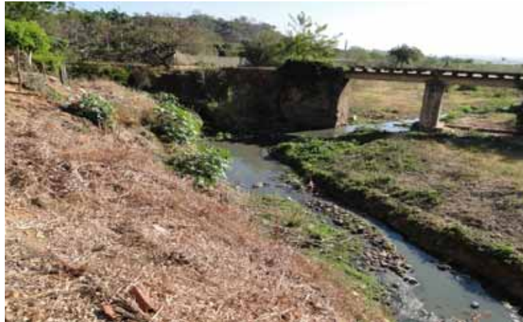
Figura 4 – Esgoto no rio Granjeiro (UTM 9201600N / 455381E - 09.09.2010).
