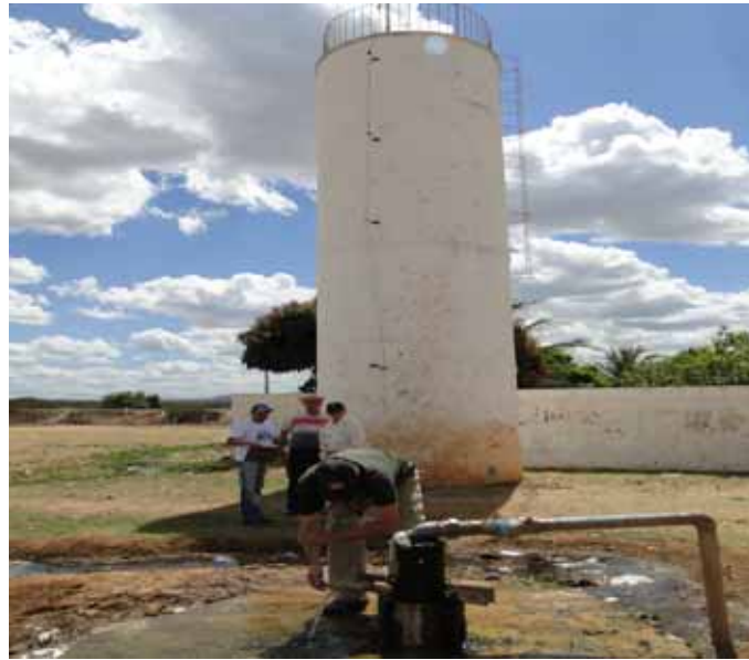
Figura 14 – Poço jorrante, Bairro Cavaco, Município de Brejo Santo (UTM 9170132N / 501452E – 09.09.2010). Cadastro SIAGAS 2300022121.
