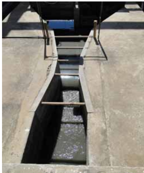
Figura 8 – Estação de tratamento de esgoto da CAGECE, Juazeiro do Norte ( ( UTM 9204018N / 467754E – 09.09.2010).
