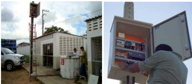
Figura 4.52- Vista geral dos abrigos contendo equipamentos de monitoramento por datalogger .
