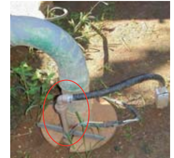
Figura 4.75 - Poço tubular com tubo guia instalado, destacado em vermelho.
